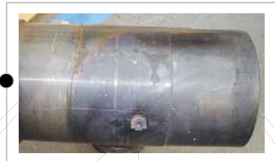
Esempio di surriscaldamento Overheating example
